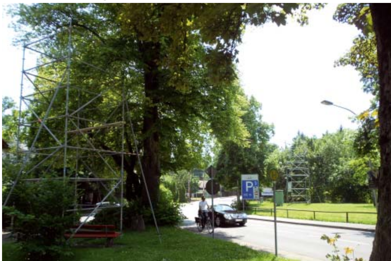
Die mit den Gerüsten dargestellte Höhe der Brücke wird sich nicht ändern, weil es niemanden geben wird, der eine Tieferlegung der Bahntrasse bezahlen wird. Die Bahn wird nur die Maßnahmen ergreifen und bezahlen, die der Gesetzgeber von ihr verlangt. BZ-Fotos (4): WV
