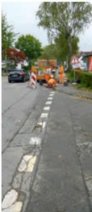
Im Lindauer Stadtgebiet haben die Straßen die letzten Jahre erheblich unter dem Verkehr, aber auch unter den starken und langen Wintern gelitten und müssen baldigst instand gesetzt werden. BZ-Foto: STS
